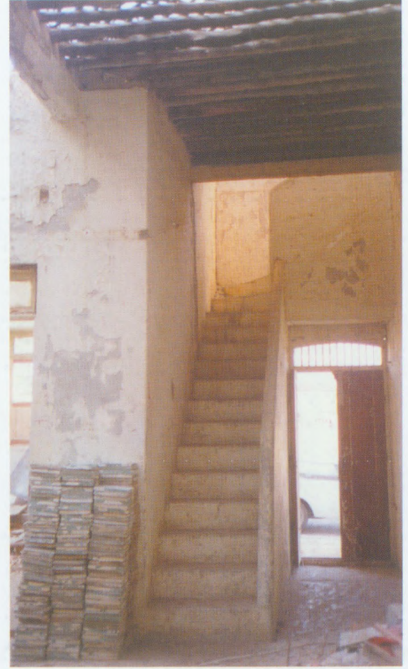
درج السطح في أحد بيوت شرق قبل الترميم.
