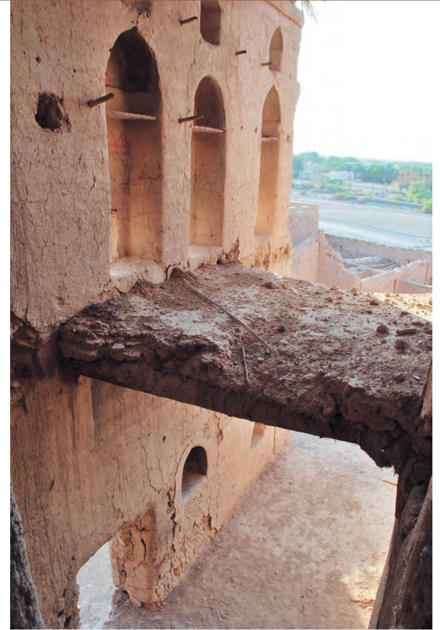
الشكل ٤-٦: السليف، تداعي الأرضيات الداخلية والواجهات.
